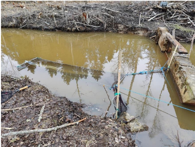
Bild 4. Ryssjans placering vid regleringsdammen. Vattnet har skapat en sidofåra förbi regleringsdammen och vandringsvägen var enkel att stänga av.
