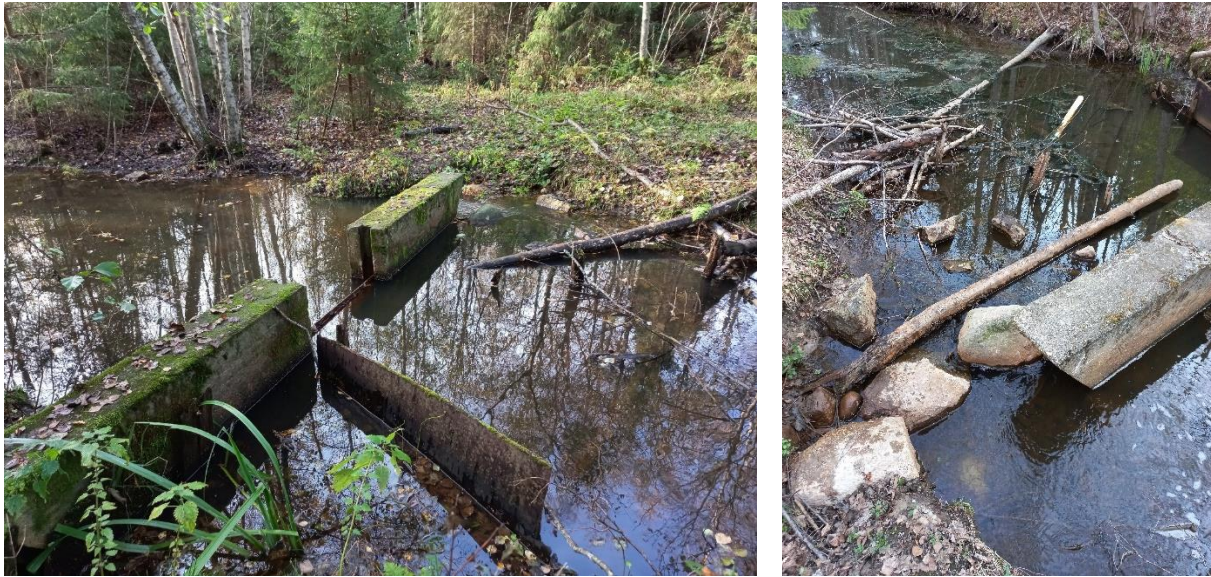
Figur 13. Gammal regleringsdamm nedströms Permofladan. Vattnet har eroderat en fåra runt dammens västra sida där fisk torde kunna passera vid tillräckligt vattenflöde. Foto: Anna Sundelin, bilden till vänster 3.10.2023, bilden till höger 16.5.2023.
