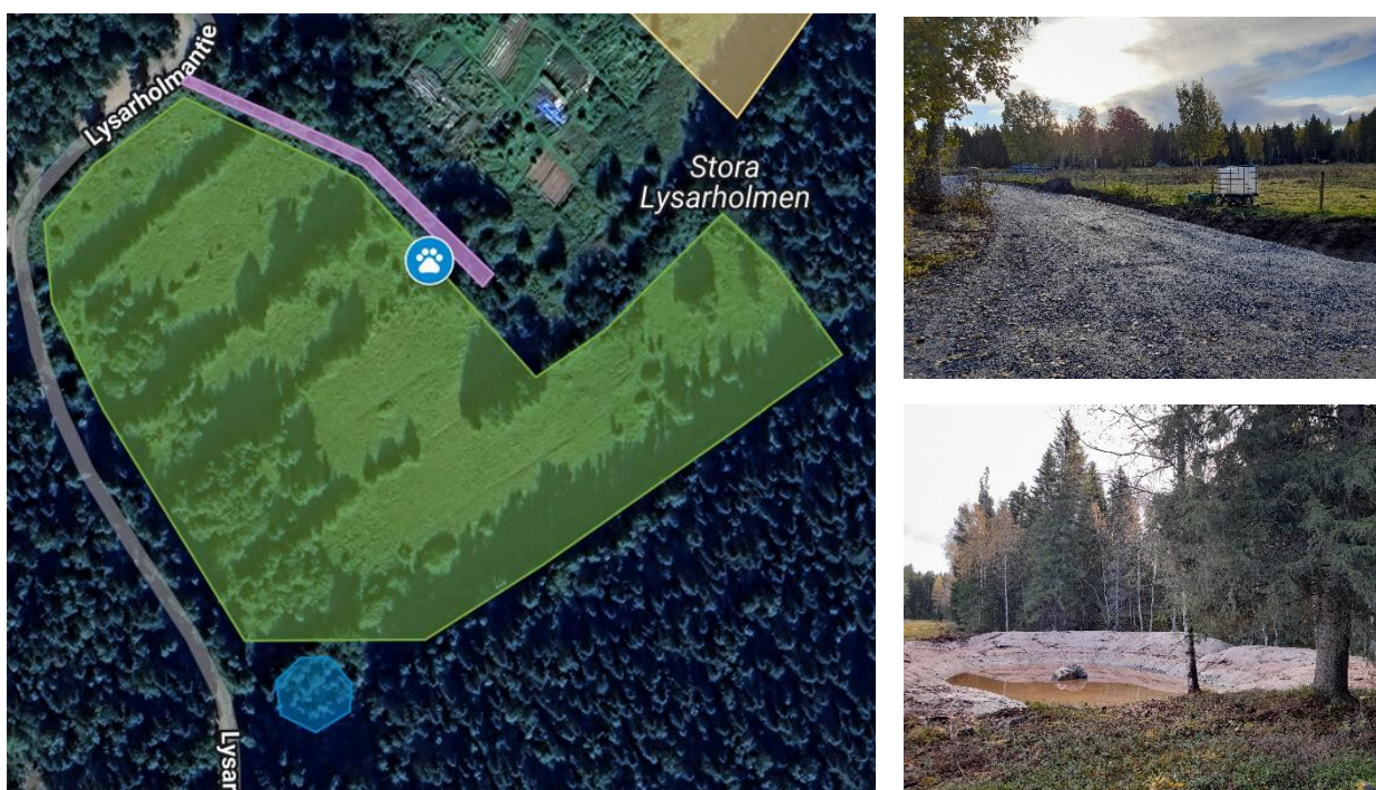
Figur 7. Den rosa markeringen står för serviceväg och den blåa markeringen står för damm. Uppe till höger servicevägen och nere till höger dammen under konstruktion.
