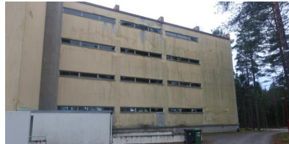
Länsisiiven pohjoinen julkisivu. Ilmastointikone on piilotettu matalan muurin taakse.
