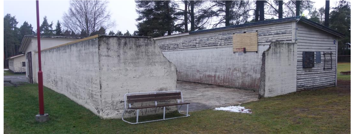
Julkisivut etelä-itä. Hiilivaraston seinämään on kiinnitetty koripallokori.
