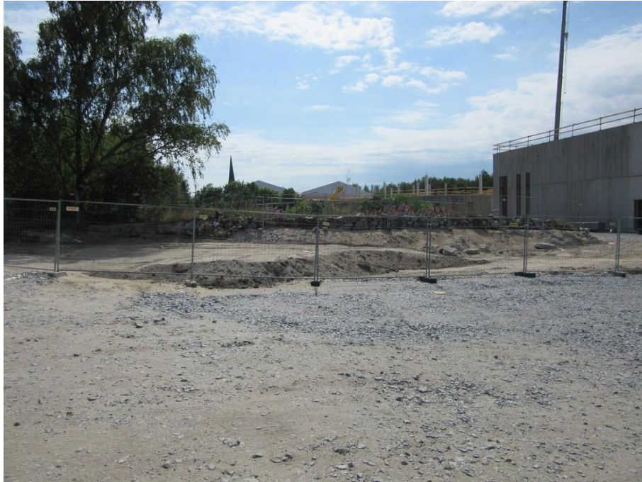
Galgbacken. Muren öster om ishallen var utanför området för schaktningsarbete, fotograferat mot söder.
